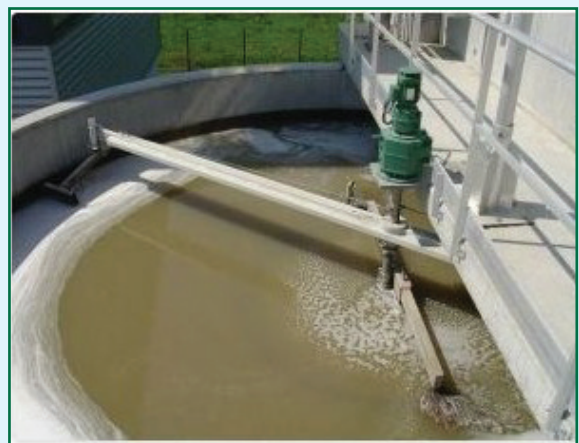
Doc. 8 Dessableur/ dégraisseur .
